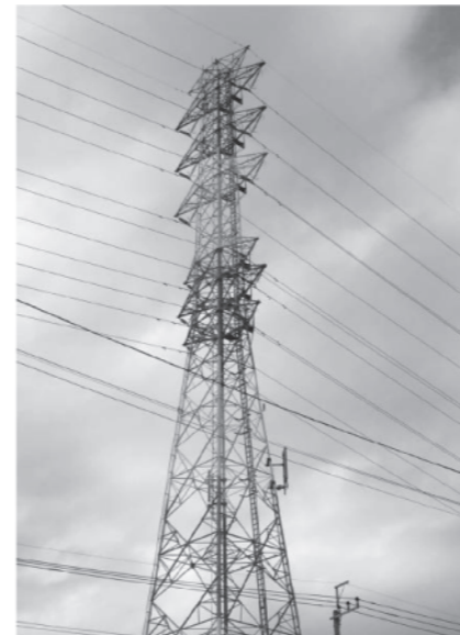
広域停電時に備え、複数の送電線および配電線ルートを形成している
