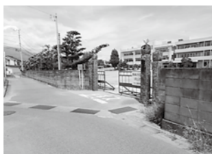
双葉西小学校ブロック塀
