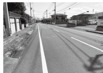
バリアフリーになっていない歩道
