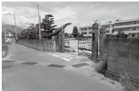
調査された双葉西小学校ブロック塀
