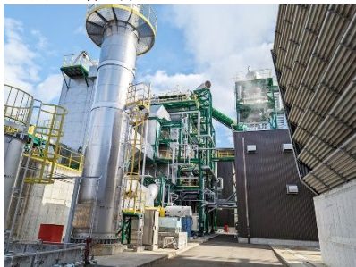
ボイラー下部
