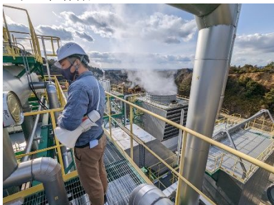
ボイラー最上部
