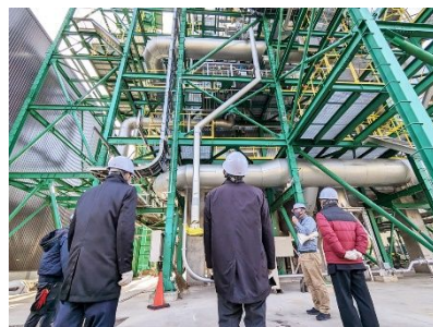
ボイラー下部
