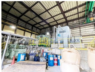
タービン棟内部
