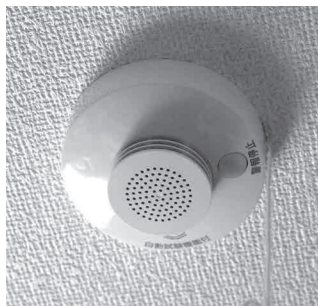
全家庭に設置義務のある火災報知器
