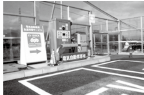
双葉サービスエリアに設置されている電気自動車充電設備
