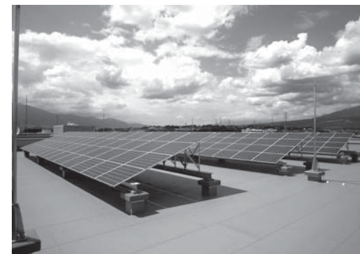
甲斐市役所「新館」屋上に設置されている太陽光パネル
