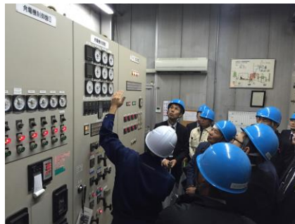
バイオマス発電設備
